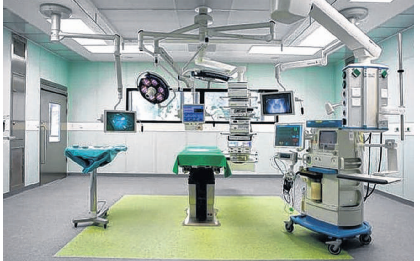
So sieht einer der neuen OP-Säle im Evangelischen Krankenhaus Wesel aus.
